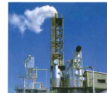
FJライト製造設備
