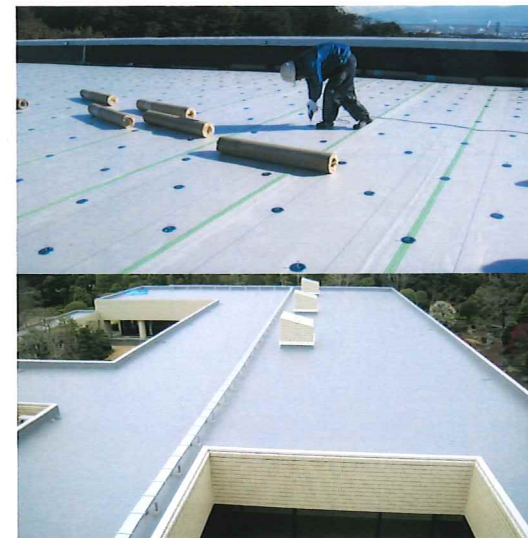
富士市斎場屋上防水改修工事 工法/塩ビシート機械固定工法
